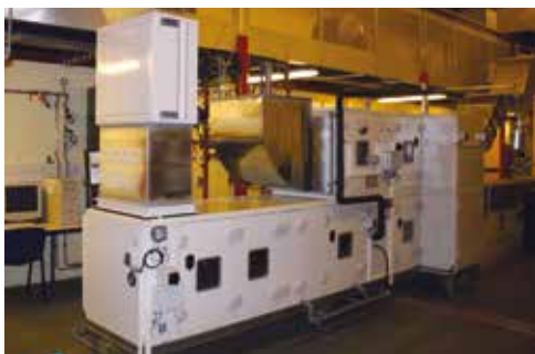
Structure de la plateforme aéroulque et rénovation centrale traitement d'air (spécialité génie climatique et énergétique)
