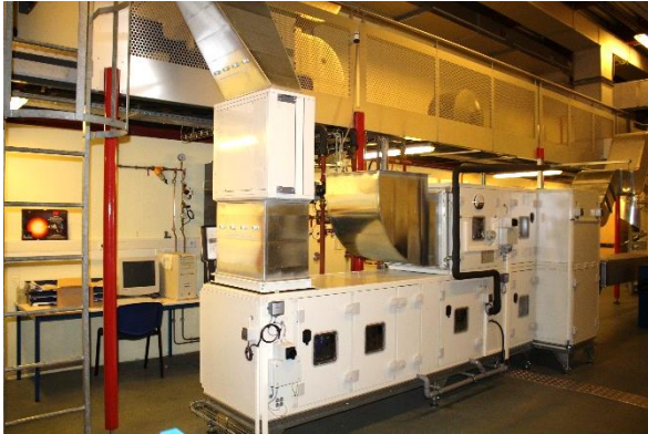
Structure de la plateforme aéronautique et rénovation centrale traitement d'air (plateforme Climatherm)
